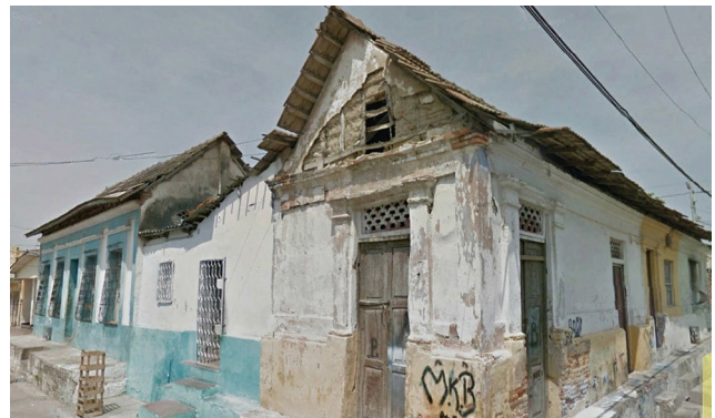
Imagen 10. Casa esquinera ubicada en la calle 35 con carrera 30 en los límites de los barrios San Roque y Chiquinquirá. En la parte superior de la culata se puede observar la estructura del bahareque por la caída del pañete. En casi todos los casos analizados se encontró que las bases de las pilastras pueden tener una altura de un metro y se extienden, a manera de zócalo, a todo lo largo del muro de la fachada. Este elemento con toda seguridad no solo cumplía una función decorativa sino que al construirse en ladrillo tenía por finalidad proteger el bahareque de las salpicaduras del agua. (Fuente: Google Earth)
