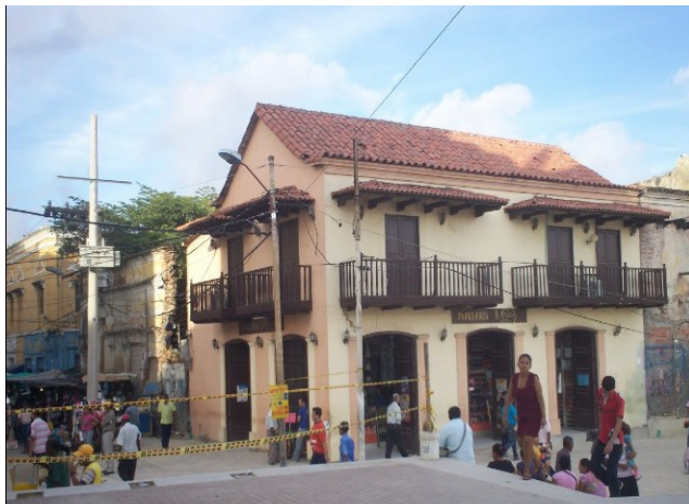
Imagen 29. Casa colonial de dos pisos ubicada en la calle 30 con carrera 41. Aún se observan los canes del balcon corrido por ambas caras de la fachada y los vanos clausurados del segundo piso.
