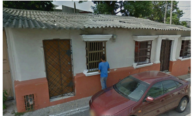
Imagen 16. Casa de dos habitaciones medianeras en la calle 46 del Barrio Abajo. La cubierta fue remplazada por láminas de asbesto cemento. (Fuente: Google Earth)
